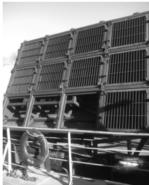
Рис. 4. Рыбозащитное устройство оголовка НС-1 подъема НФС-1
