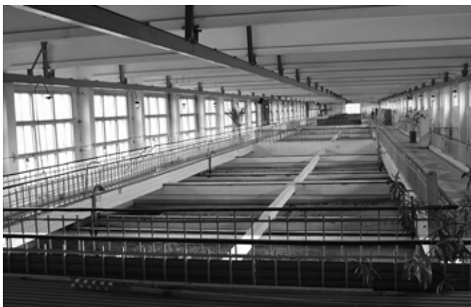
Рис. 3. Технологическая очередь НФС-1 с водо-воздушной промывкой фильтров
