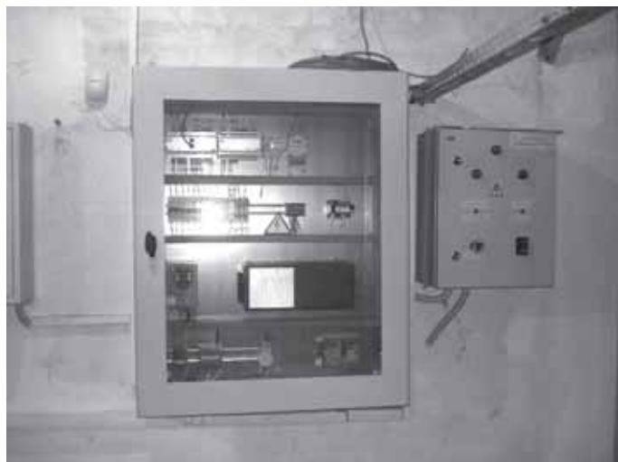
Рис. 2. Шкаф управления ПНС
